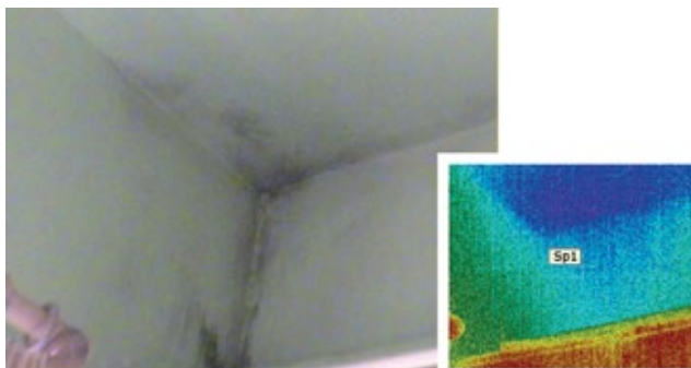
Ανάπτυξη μούχλας λόγω απουσίας θερμομόνωσης και συμπύκνωσης υδρατμών
