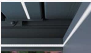
Προσθήκη LED λαμπτήρων για πρόσθετο φωτισμό.
