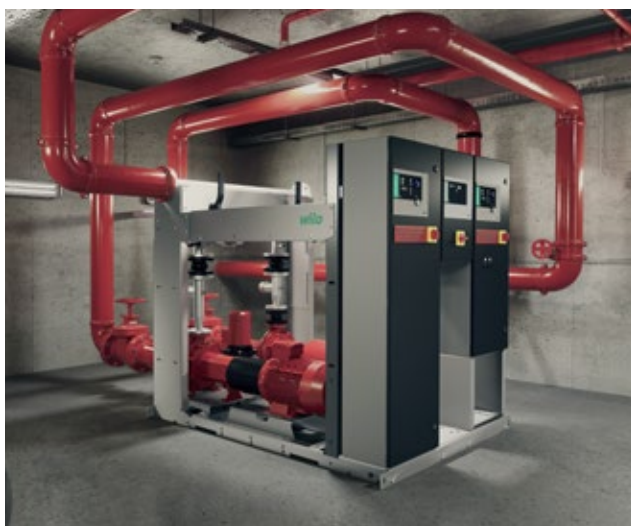
Εικόνα 3: Μηχανοστάσιο πυρόσβεσης Wilo-SiFire, με αντλητικό συγκρότημα και δίκτυο σωληνώσεων.
